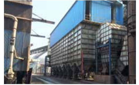
1 no.’lu Yüksek Fırın Dökümhane Toz Toplama Sisteminin İyileştirilmesi
